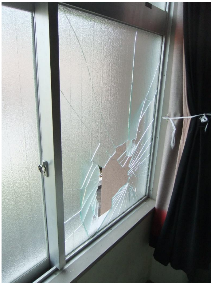
ボールがあたって窓ガラスが割れた
