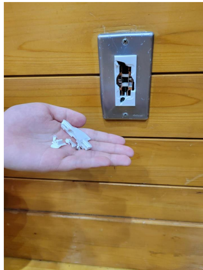
コンセントの破損
